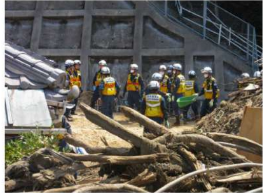
広島県坂町小屋浦地区（8月7日）
