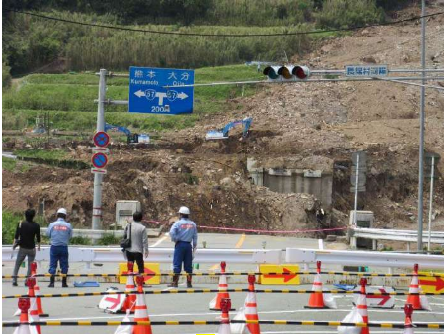
「阿蘇大橋」崩落の現場 (5月5日)
